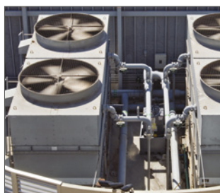
FAN AND PUMP
